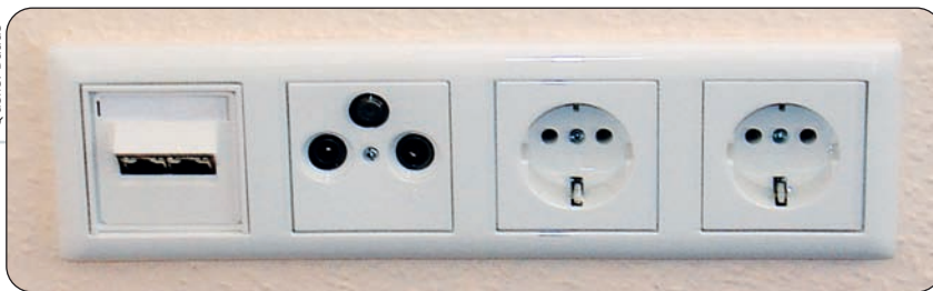
Bild 6: Nicht normgerechte Installation – nur zwei statt drei Netzsteckdosen neben dem Radio-/TV-/Datenanschluss
