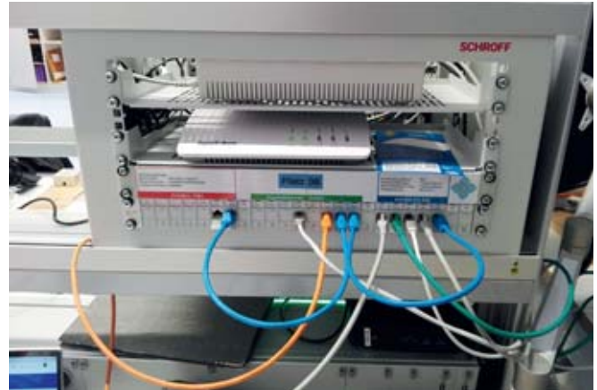
Bild 3: Die »Fritzbox 7590« wird im Karlsruher Techniklabor eingesetzt
