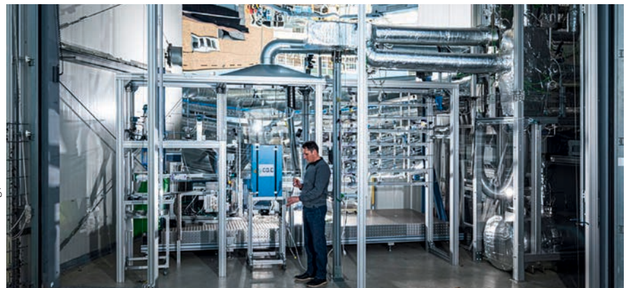
Bild 2: Der neue »Necoc«-Anlagenverbund am KIT produziert den Hightech-Rohstoff Kohlenstoff aus dem klimaschädlichen CO 2 der Umgebungsluft
