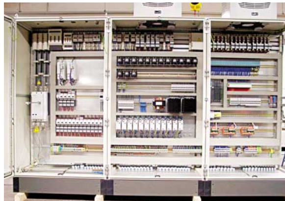
Bild 5: Anhand der CAD-Daten wird der Schaltschrank angefertigt und geliefert
