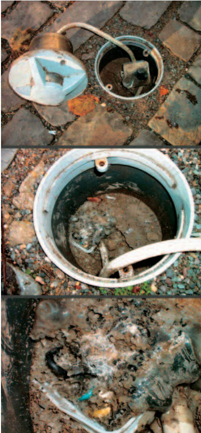
Bild 2: Anschluss von Gehwegleuchten als tickende Zeitbomben
