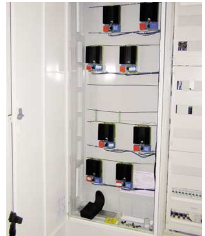
Bild 2: Ein Wärmestau im Verteilerschrank kann zum Trafoausfall führen und Quelle eines Brands mit unvorhersehbaren Folgen sein
