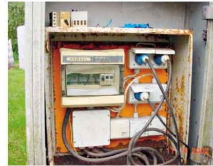
Die RCDs wurden aus dem auch sonst unbrauchbaren Campingplatzverteiler entfernt – Lebensgefahr!
