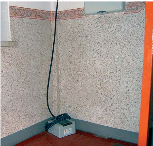
Bild 19: Oben wie unten Pfusch: freiliegende Adern direkt in beiseite geschobenen Berührungsschutz eingeführt; ein Zähler und ein Knoten bilden keine zulässige Zugentlastung
