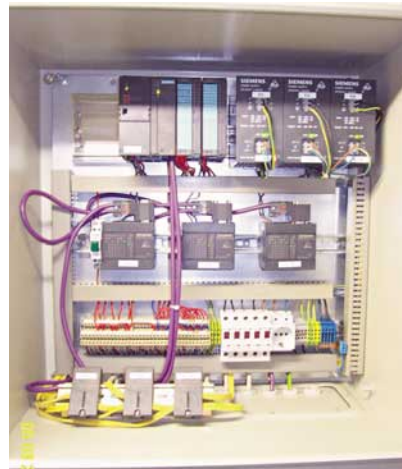
Bild 1: Steuerung der Signalsäulen und Anzeigeeinheiten mit Hilfe einer S7-300 von Siemens; links unten im Bild die drei Gateways von Profibus DP zu AS-i
