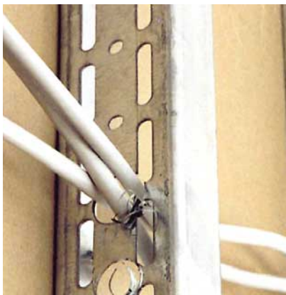
Scharfkantige und mit Grat versehene Bohrungen in Metallständern führten zur Beschädigung von Basis- und Aderisolierung
