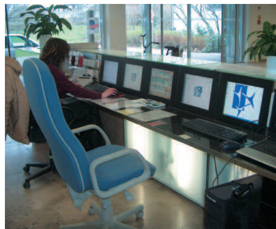
Bild 1: Touchscreens und Konsolen geben dem Personal einen guten Überblick über die Gebäudetechnik
