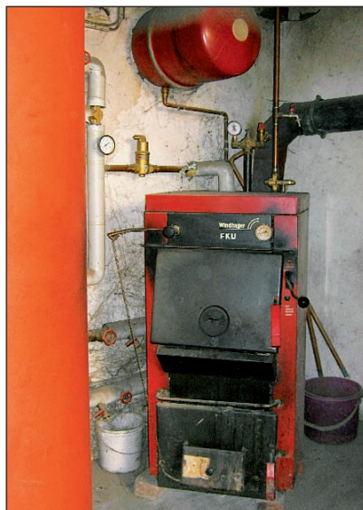
Bild 1: Der Austausch veralteter Wärmeerzeugers gegen moderne Aggregate ist nur ein Teilaspekt bei der Heizungsanierung
