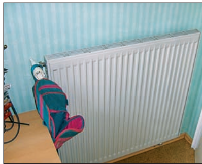
Bild 3: Für Anlagenoptimierung muss die Position eines jeden Heizkörpers berücksichtigt werden
