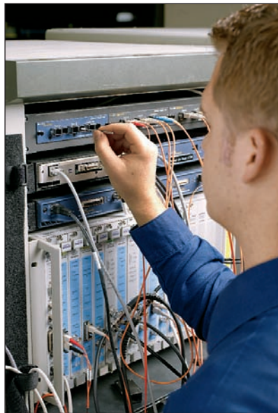
Bild 2: Die Hauptursache für Ausfälle von Glasfaserverbindungen sind Schmutzablagerungen. Mithilfe von speziellen Tupfern in der richtigen Größe können Anschlüsse innen gereinigt werden. So lässt sich eine Problemquelle ausschalten, die häufig übersehen wird
