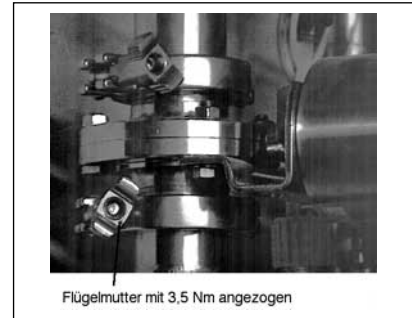
Bild 2: Rohrverbindung am Schieber
