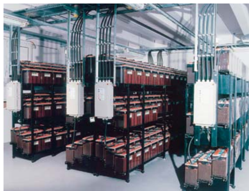
Bild 2: Batteriestapel für die USV-Anlage; auch von der ausreichenden Dimensionierung der unterbrechungsfreien Stromversorgung hängt die hohe Verfügbarkeit des Netzwerkes ab
