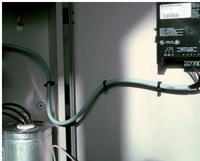
Bild 1: Ansicht der Verbindung Schaltschrank – Blindleistungsregler
