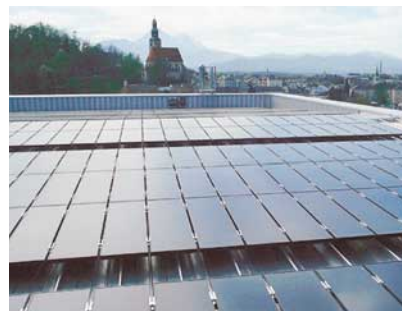
Bild 1: Anlage mit CIS-Modulen auf der Kongresshalle Salzburg; neben dem hohen Wirkungsgrad stellt das CIS-Modul einen ästhetischen Wert dar
