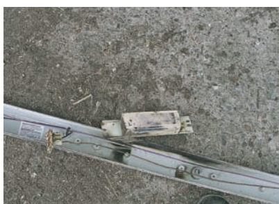
Bild 12: Hier eine der Leuchten, die an der Decke im Bild 11 montiert waren. Da diese Leuchten nicht bei unzulässig hohen Temperaturen abschalten können sie – auf brennbaren Untergründen montiert – großen Schaden anrichten
