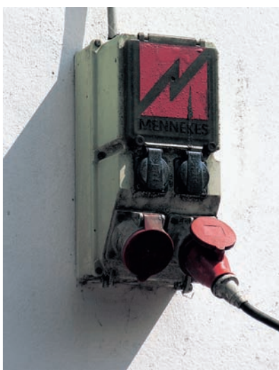
Bild 5: Regelmäßige Pflege und gutes Material machen sich bezahlt: Die an der Außenwand montierte Steckdosenkombination verrichtet ihren Dienst bereits seit über 15 Jahren
