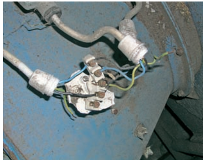
Bild 1: Bei Berührung Stromschlag: Uralter, zerbrochener Klemmstein, nicht angeschlossene Schutzleiter, von der Verteilerdose existiert nur noch der Boden
