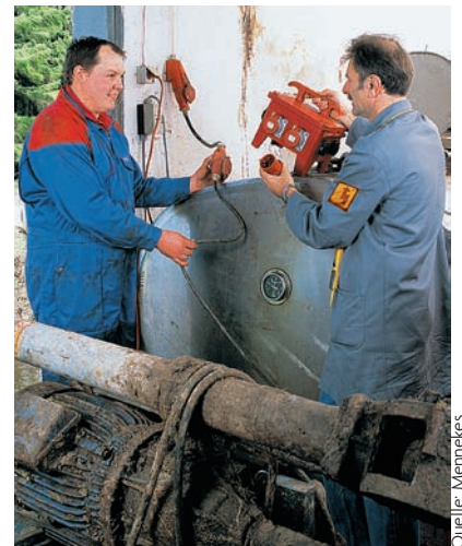
Bild 3: Statt des bisher eingesetzten unzulässigen Adapters mit 32-A-Stecker und 16-A-Kupplung empfiehlt der Elektrofachmann, hier einen robusten Vollgummiverteiler des Typs »Evergum« mit integrierter Einzelabsicherung der Stromkreise einzusetzen
