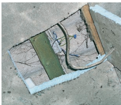
Bild 10: Leitungsführung unerreichbar hinter einer Styropor-Decke, verdrahtet in nicht selbst verlöschenden Abzweigdosen – eine potenzielle Brandgefahr
