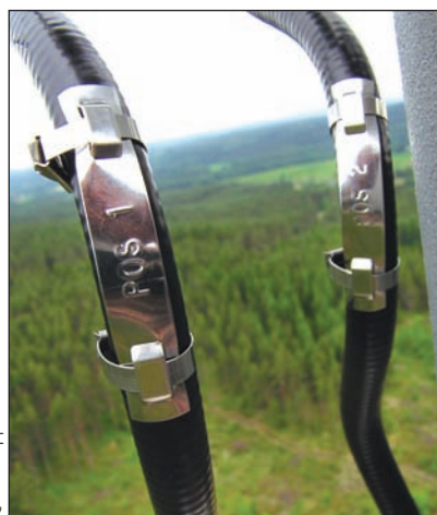
Bild 3: Beispiel einer Edelstahl-Kabelkennzeichnung an Sendemasten
