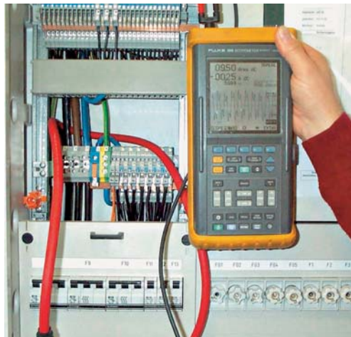
Bild 3: An dieser Unterverteilung im TN-C-S-System fließen 9,5 A nicht über den PEN; sie vagabundieren über leitfähige Gebäudenebenwege, z.T. auch über Schirme von Datenleitungen
