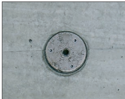
Bild 8: Erdungsfestpunkt in Betonwand
