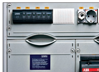
Bild 3: Überspannungsschutzkombination (Typ I + II) in der Unterverteilung wirkt gegen Blitzströme
