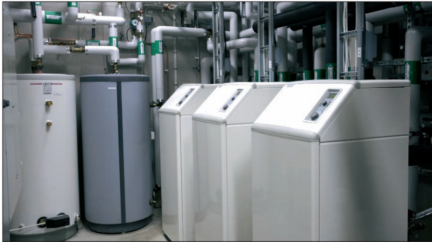
Bild 3: Die gesamte Technik der Heizungsanlage für das Clubhaus des Halmstad Golf Clubs ist an eine Alarmanlage angeschlossen, die alle Prozesse fortlaufend überwacht
