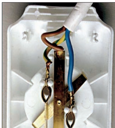
Bild 4: In den Handel gelangtes Produkt mit vertauschtem Außen- und Schutzleiter. Eine Erstprüfung vor der Inbetriebnahme ist daher notwendig
