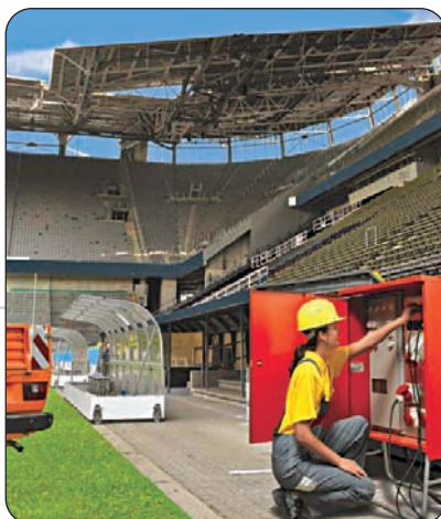
Bild 9: Visuelle Zuordnung und Messgrößenerfassung der überwachten Stromkreise
