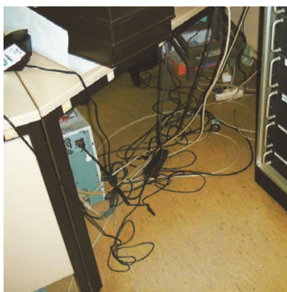
Bild 3: Unzulässige Verwendung von ortsveränderlichen Mehrfachsteckdosenleisten
