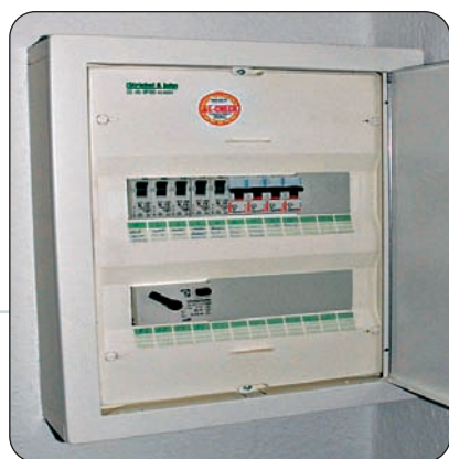
Bild 1: Stromkreisverteiler, wie er in unzähligen Anlagen vorkommt
