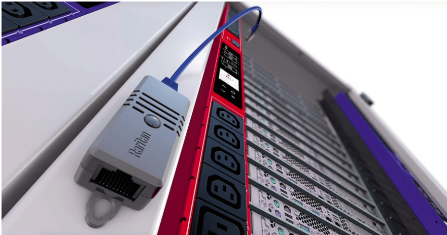
Bild 2: Die programmierbaren iPDUs von Raritan verteilen und messen nicht nur Strom, sondern verfügen zudem über einen RJ12-Sensor-Port
